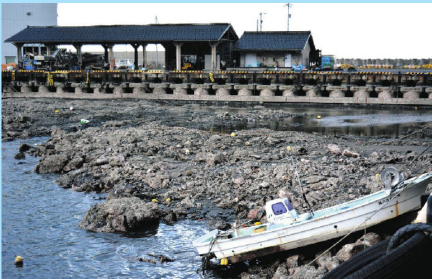
岸壁が4m 隆起した輪島・・・中日新聞より
