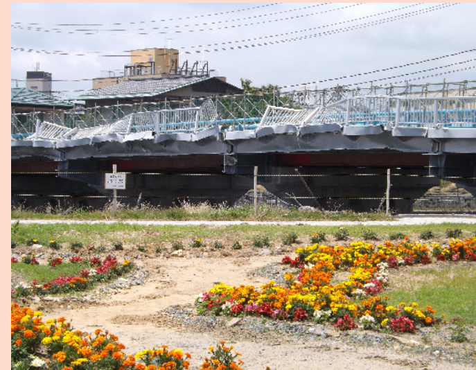
大震災1年3ヶ月後—市街地東端の未修理の橋
