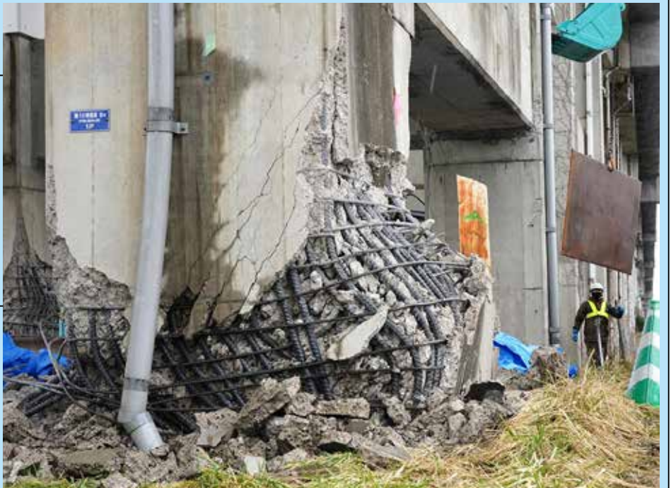
東北新幹線橋脚損傷・・・日経新聞より
