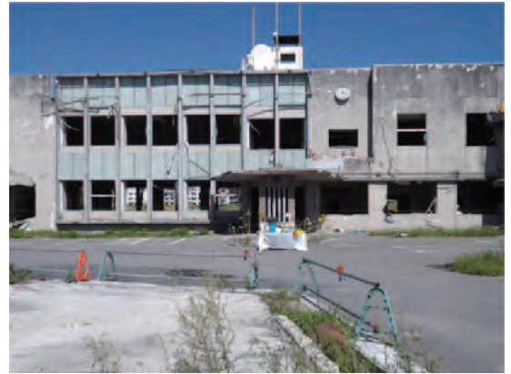
破壊されたままの大槌町役場
