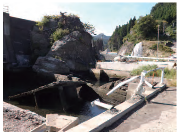
両石-壊れたままの防波堤裏側
