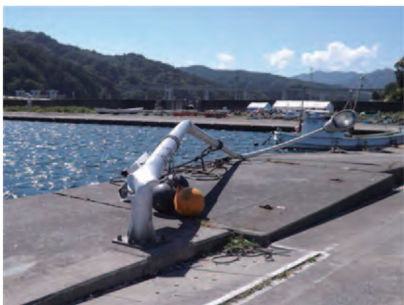
山田-折れ曲がった岸壁の街灯
